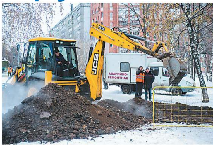
Повреждение теплотрассы на улице Студеной устраняли четыре ремонтных бригады.
